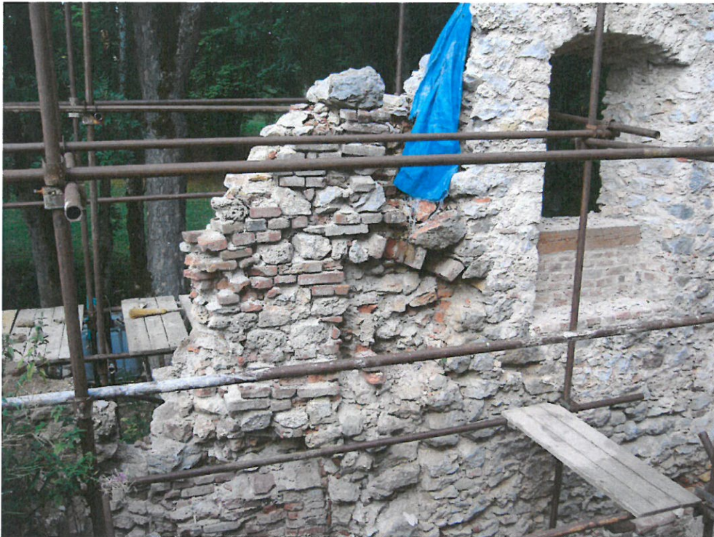
Severná stena Domu Veliteľa, kde pekne vidno náročnosť riešenia situácie z pohľadu metodického, aj remeselného.
